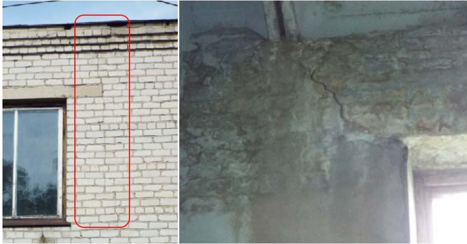
Рис. 4. Вертикальные трещины шириной раскрытия до 3,0 мм в наружных стенах здания
