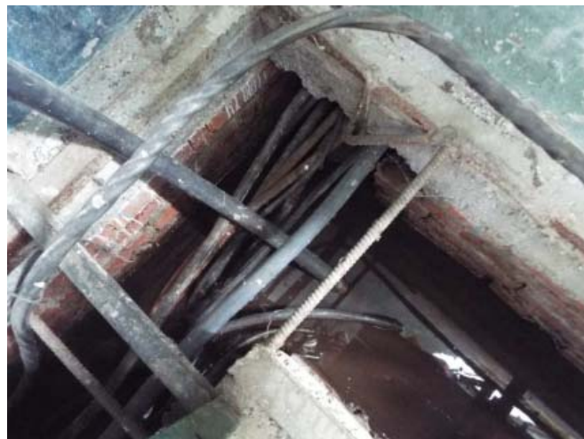
Рис. 6. Затоплены кабельные каналы в помещении распределительного устройства здания
