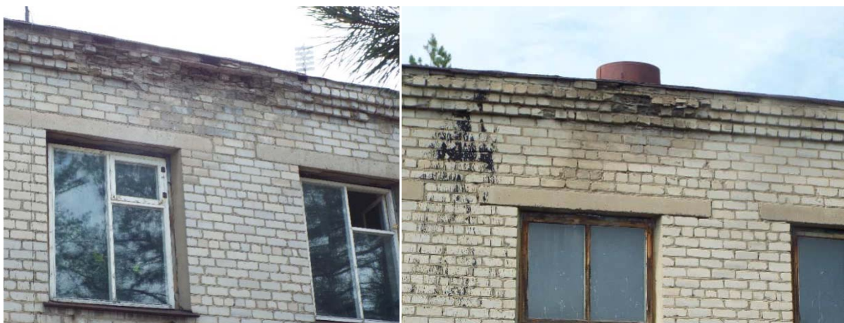
Рис. 2. Разрушение кирпичной кладки карнизных участков стен здания
