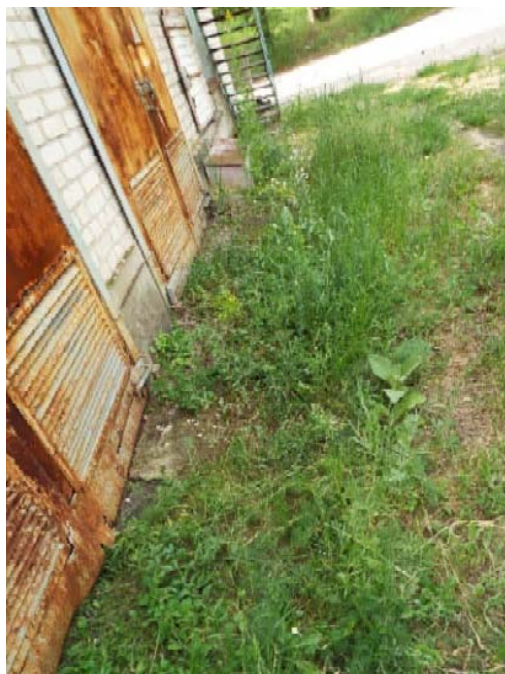
Рис. 8. Повреждение отстки по периметру здания
