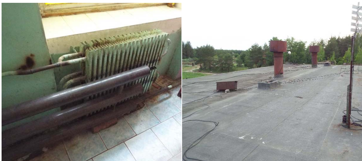
Рис. 7. Система вентиляции и отопления неисправна
