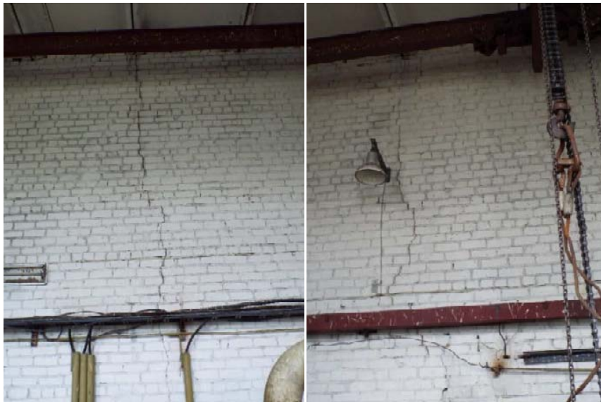
Рис. 5. Вертикальные сквозные трещины шириной раскрытия до 3,0 мм во внутренней несущей стене здания
