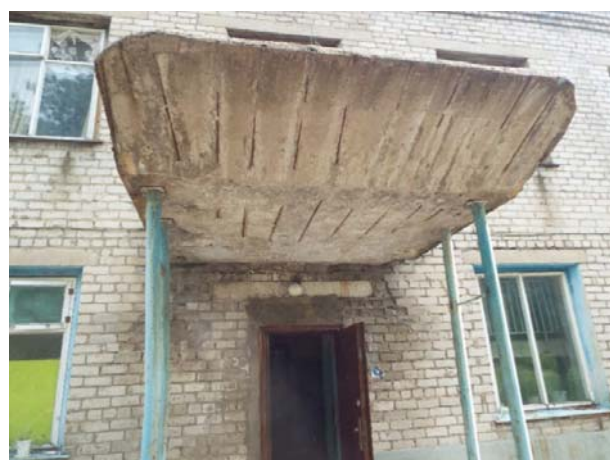
Рис. 3. Разрушение бетона, оголение и коррозия арматуры козырька входной группы
