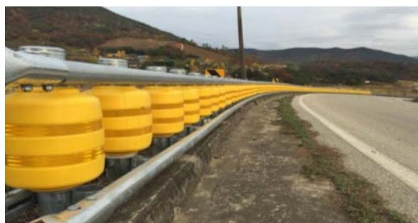
Рис. 1. Роликовое барьерное ограждение, установленное на вираже
