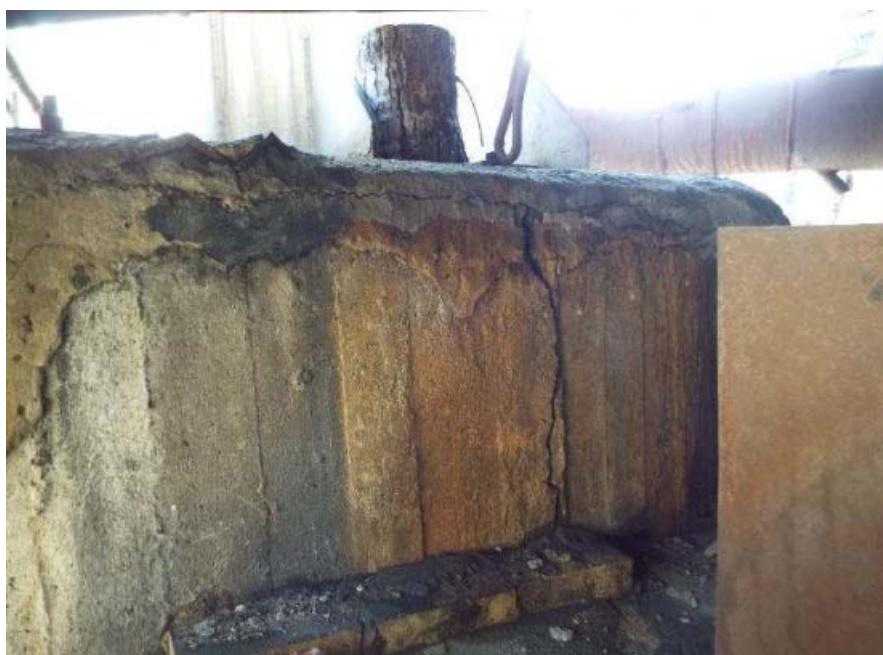
Рис. 2. Сквозная вертикальная трещина шириной раскрытия до 4 мм в железобетонном постаменте дымовой трубы
