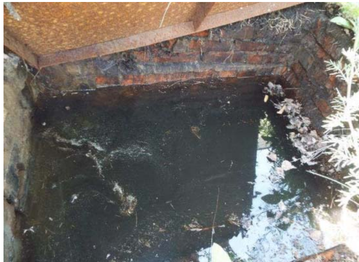
Рис. 4. Прямо́к дымовой трубы заполнен водой, подтопление фундамента
