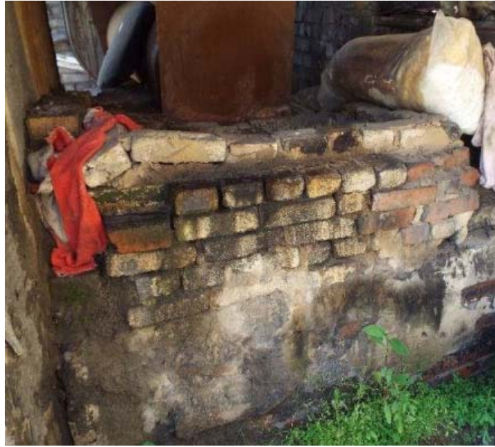
Рис. 3. Разрушение кирпичной кладки стен наземного газохода дымовой трубы
