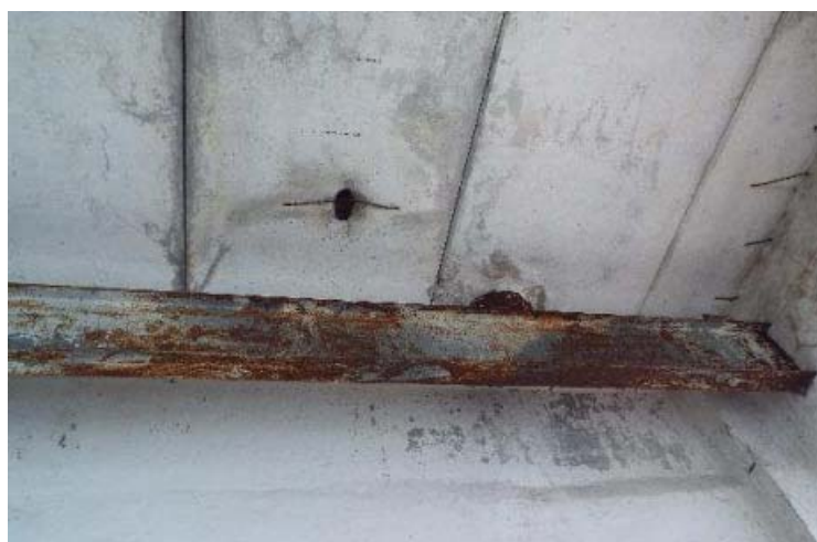
Рис. 3. Коррозия подвесных путей стальной монорельсовой балки приемной камеры КНС
