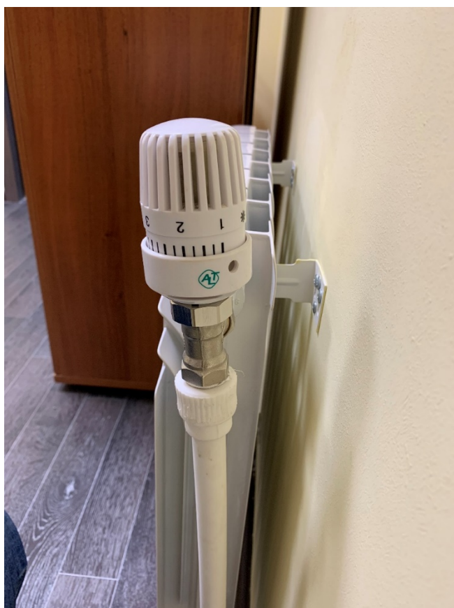
Рис. 5. Установленный терморегулятор на отопительном приборе (марка ATL)
