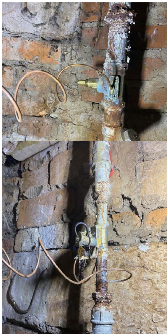
Рис. 3. Состояние запорно-регулирующей арматуры
