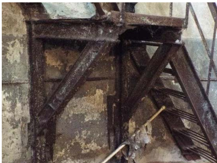
Рис. 4. Разрушение антикоррозионного покрытия, сквозная коррозия элементов лестницы приемной камеры
