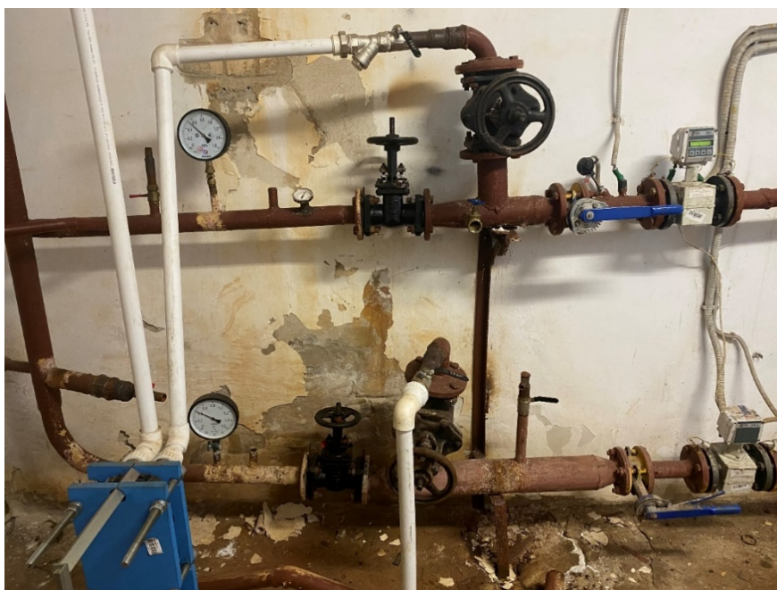
Рис. 2. Нарушение требований обеспечения чистоты технического подполья и содержания инженерных коммуникаций
