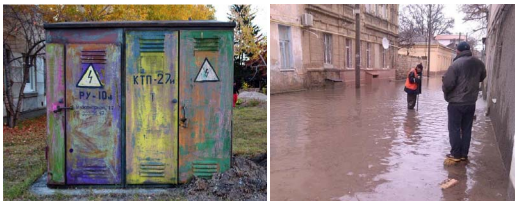
Рис. 2, 3. Типичное состояние инженерной инфраструктуры (фото К.Шишов)
