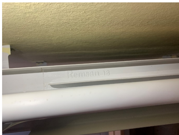
Рис. 4. Маркировка установленных отопительных приборов
