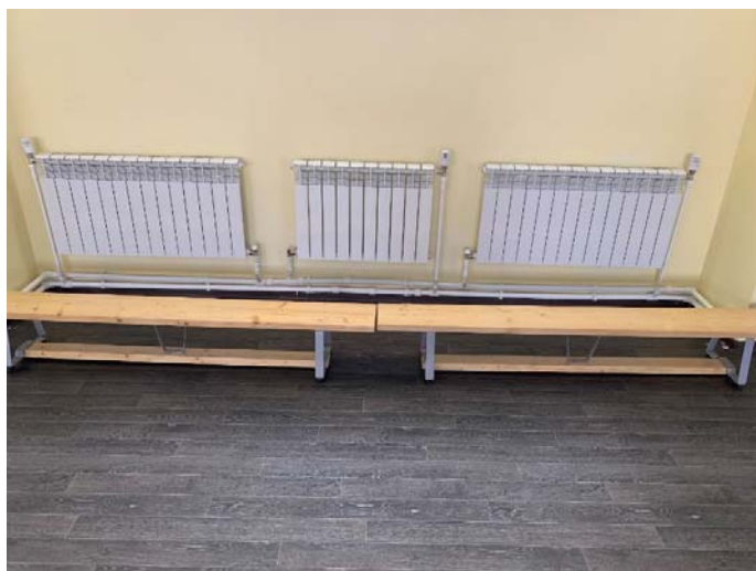
Рис. 1. Отопительные приборы не закрыты защитными экранами (радиаторными решетками). Открыто проложенные участки трубопроводов
