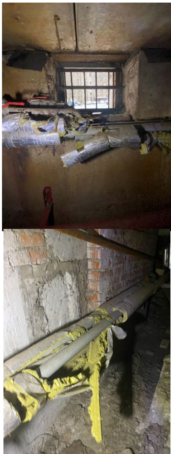
Рис. 1. Нарушение теплоизоляции трубопроводов системы отопления
