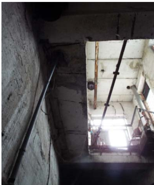
Рис. 2. Разрушение защитного слоя, оголение и коррозия арматуры монолитной плиты перекрытия приемной камеры КНС
