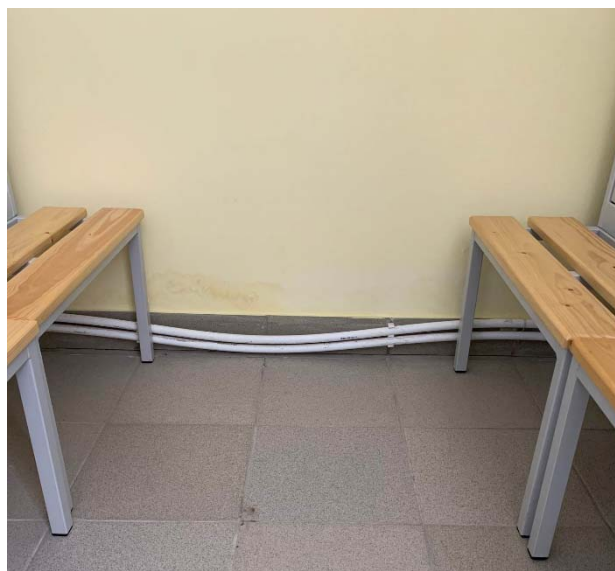
Рис. 3. Открыто проложенные участки трубопроводов. Деформация в виде прогиба
