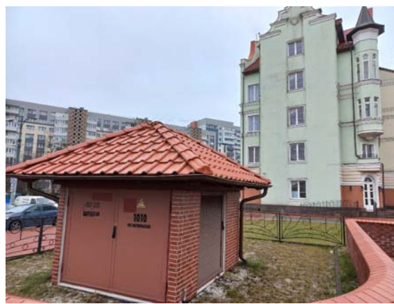
Рис. 11. Современная трансформаторная подстанция 10 кВ в жилом районе г. Калининграда (фото К.Шишов)
