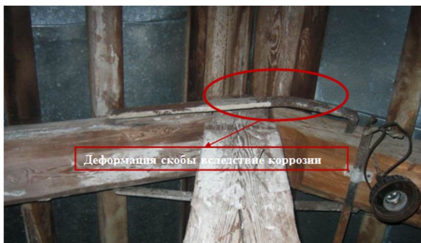
Рис. 3. Деформация скобы вследствие коррозии
