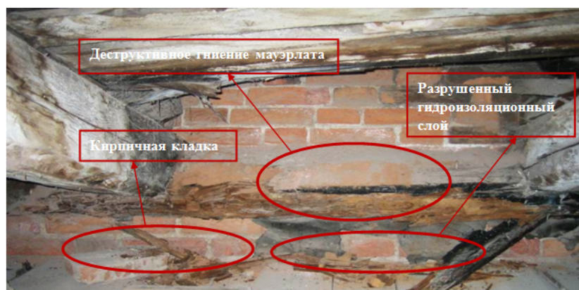
Рис. 2. Деструктивное гниение маэрлата, вследствие разрушенного гидроизоляционного слоя между кирпичной кладкой и деревянными конструкциями крыши
