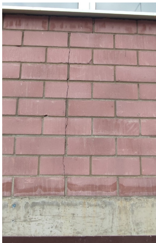
Рис. 1. Вертикальная трещина в облицовочной кирпичной кладке многослойной стены под оконным проёмом
